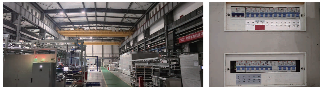
西安工厂实施节电行动现场
